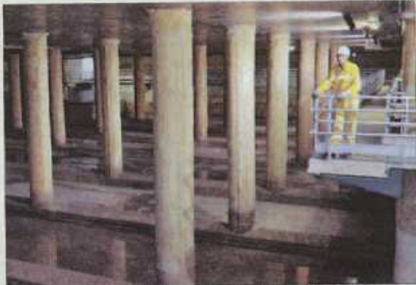
►► Interior del dipòsit d'aigua pluvial sota el parc de l'Escoador.
